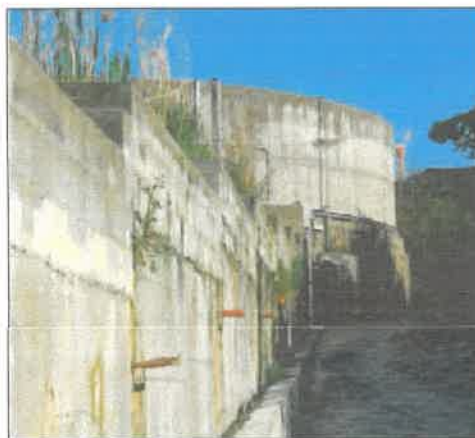
Figura N° 11: Salida De Percolado
